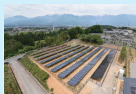
リユース品を使用した発電所
