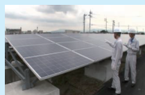
太陽発電設備の検査の様子
