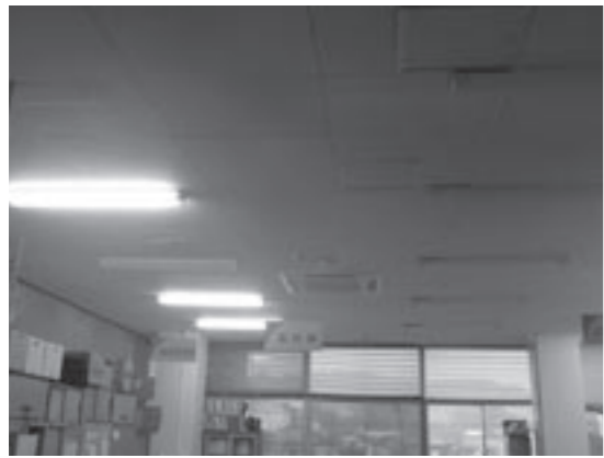
間引きされた照明
